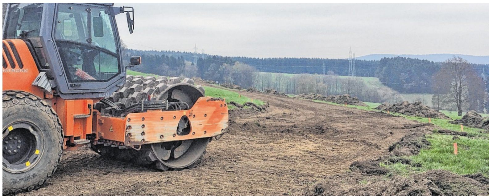
Die Baustraße zum Rahrbacher Windpark entsteht nun von der Kreisstraße 18 aus. Hier werden die riesigen Windkraftanlagen aufgestellt.
