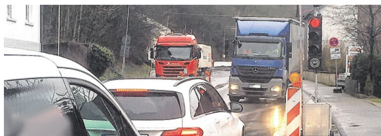
Eine Situation, die Autofahrer in Lennestadt kennen: Sie müssen vor einer Ampel, wie hier in Grevenbrück, warten. Grund sind Straßenbauarbeiten. FOTO: VOLKER EBERTS
