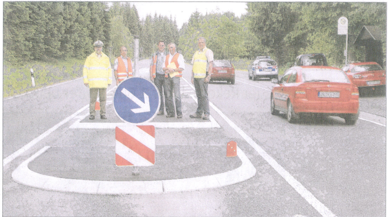
Gaben gestern die entschärfte Bundesstraße 55 im Bereich von Neuenwald für den Verkehr frei (von links): Reinhard Schulte (Kreispolizeibehörde Olpe), Manfred Lehmann und Gregor Solbach (Straßenmeisterei Lennestadt), Eberhard Zimmerschied (Straßen NRW) sowie Thomas Feldmann (Stadt Olpe). Foto: Michael Alexander
